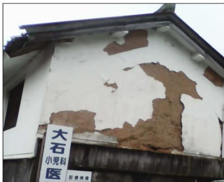
剥がれ落ちた壁(白壁土蔵群)
